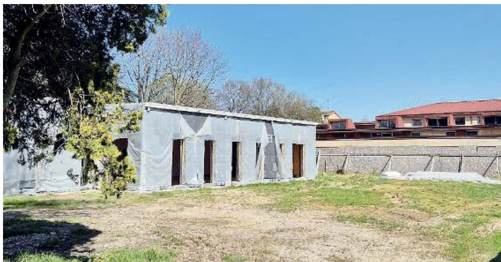
Tutto fermo. La realizzazione della nuova mensa della scuola primaria è legata alla scadenza del Pnrr
